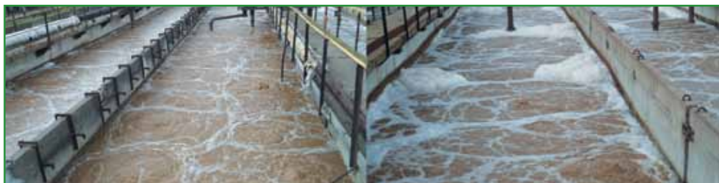
Рис. 4. Система аэрации аэротенка биологических очистных сооружений комбината (слева – на основе немембранных элементов с пристенной раскладкой, справа – на основе трубчатых мембранных элементов ОТТ MAGNUM с поперечной раскладкой)
