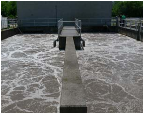
Рис. 5. Аэраторы OTT MAGNUM в аэротенке
