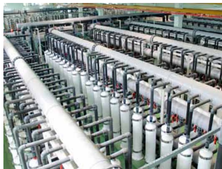
Сооружения ультрафильтрации с модулями Liqui-Flux® для доочистки сточных вод
